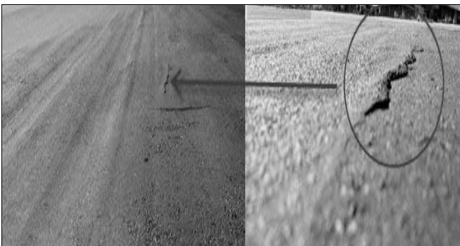
รูปที่ 1 การเสียหายที่บริเวณพื้นผิวที่อยู่ภายในแนวล้อของอากาศยานขับเคลื่อนผ่าน (Rutting)
